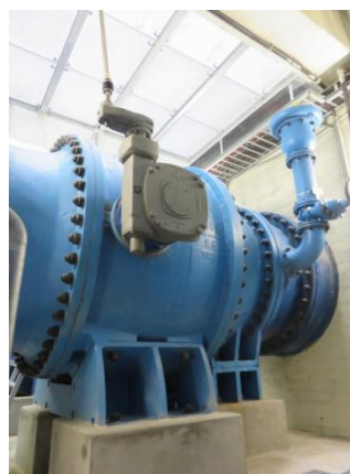
Grundablass mit Absperrarmatur
